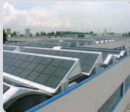
Impianto FV da 330 kWp totalmente integrato (FE)
